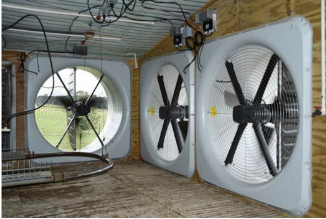
圖(五)、55 吋變頻風扇與變速裝置(風扇上方)
