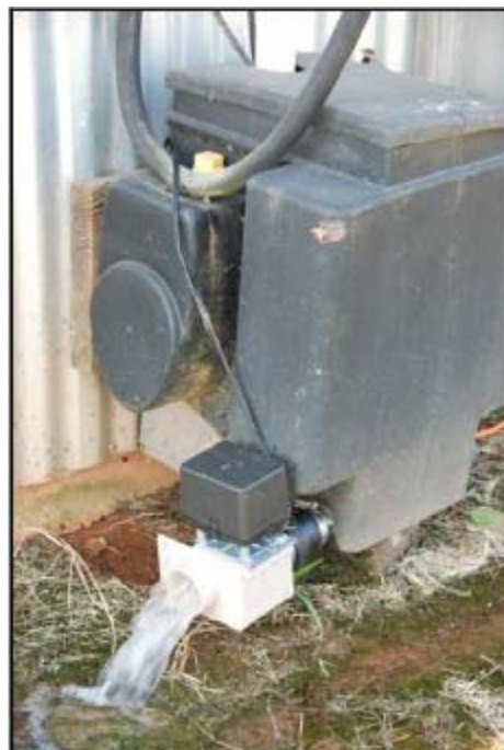
Figura 4. Válvula de drenado eléctrica.
