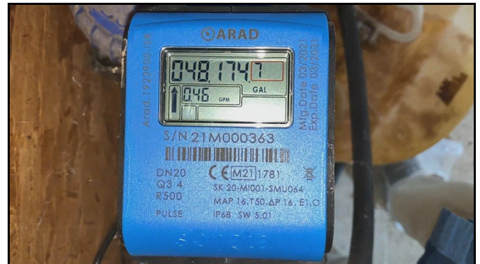
Figura 4. Medidor do extremo do exaustor.
