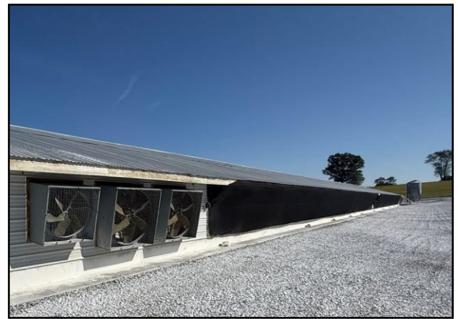
Figura 6. Malla cubriendo gran área de sistema de entada lateral de una caseta
