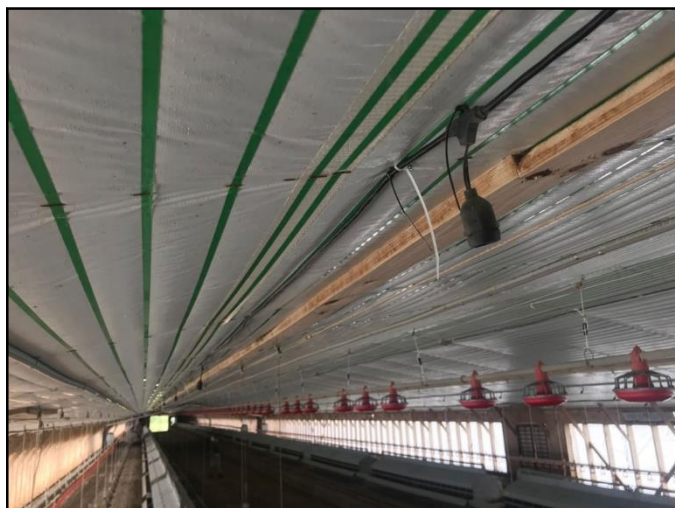
Figura 4. Cables instalados sobre nidos
