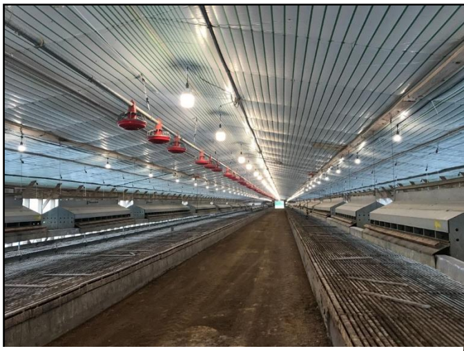
Figura 5. Sistema de iluminación LED instalado
